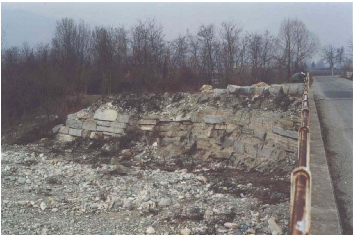
Foto 13 – Opera ZANEDS003 . Scogliera in massi parzialmente danneggiata, in sponda sinistra del F. Po a monte dell'opera BATTPO004.
